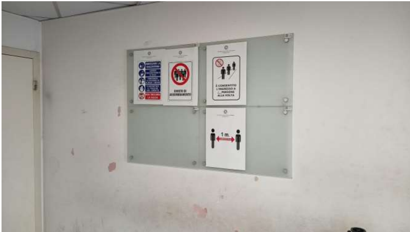
SEGNALETICA DI SICUREZZA
